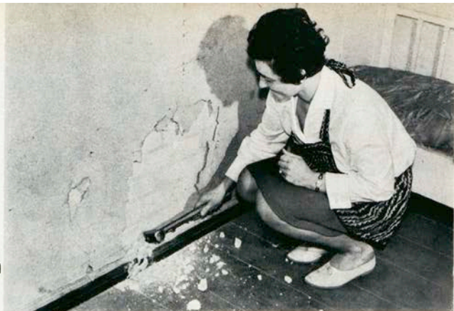
Putzschaden in der Wohnung eines Berliner Miethauses. Jeder kennt die Regel: Was lose ist, muß ab! Und so wurden aus dieser kleinen Stelle immerhin 2 m 2 . „Besorgen Sie sich Mörtel, und ich werde Ihnen das Loch gelegentlich neu verputzen“, sagte Nachbar P. zu Frau K.
